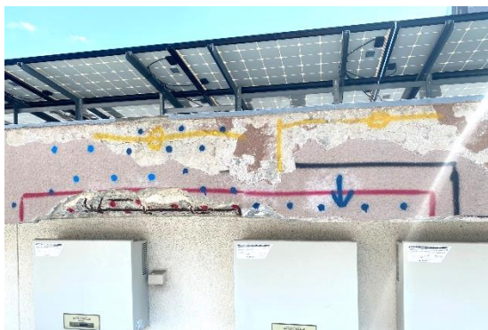
本堂屋上部爆裂補修工事 爆裂：永年の雨水により鉄筋が錆びてコンクリートをはがしてしまう現象
